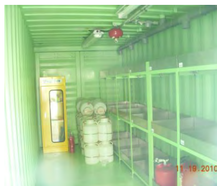
圖 7-14 實驗室廢液暫存間(內部)
